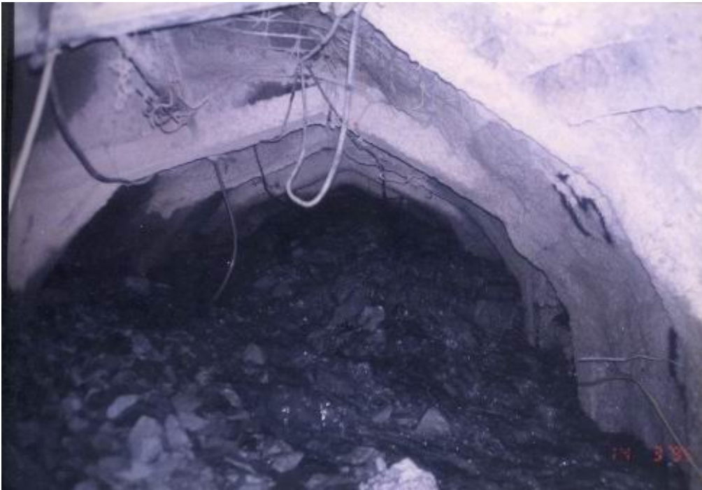
圖 18 迂迴隧道抽坍情形
